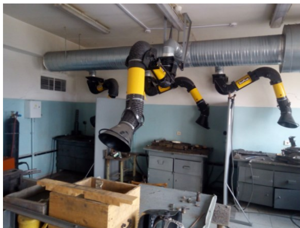
Рис. 1. Электросварочное помещение учебной мастерской
